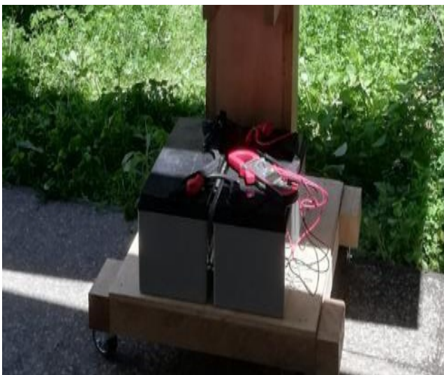
Figura 3 banco de baterías
