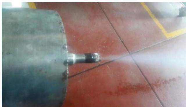
Figura 4. Inyección de vapor a través de la tobera
