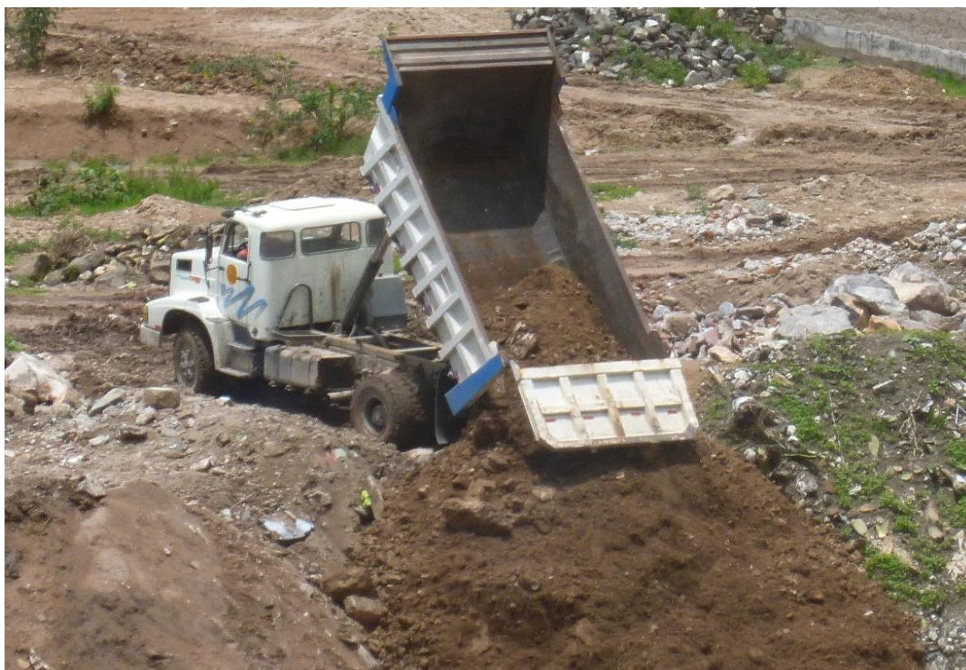
Fig. 16. Materiales sedimentarios urbanos y residuos sólidos van relleno los cauces de las quebradas de Chaquihuaycco.
