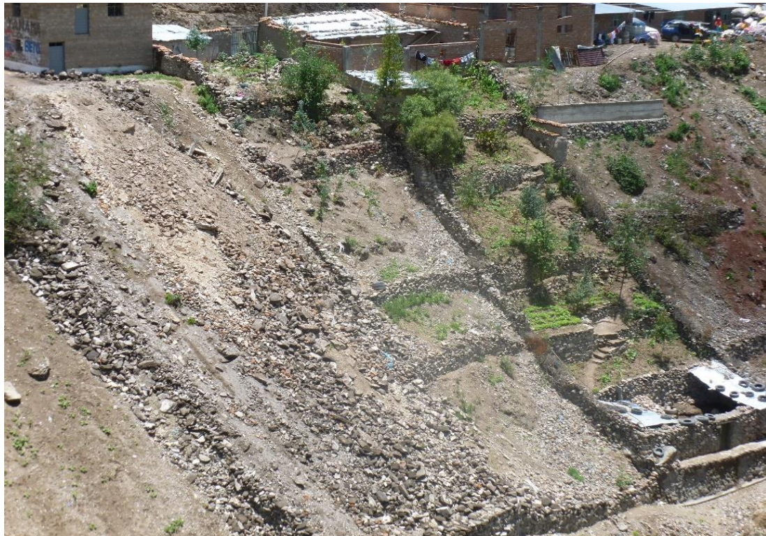
Fig. 9. Faja marginal de alta vulnerabilidad cimiento de las casas en terrazas, Q. ChaquiHuaycco.
